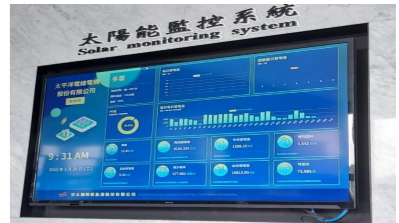
太電楊梅工廠監控系統
