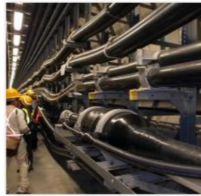
地下輸電線路
