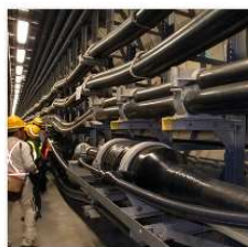
地下輸電線路
